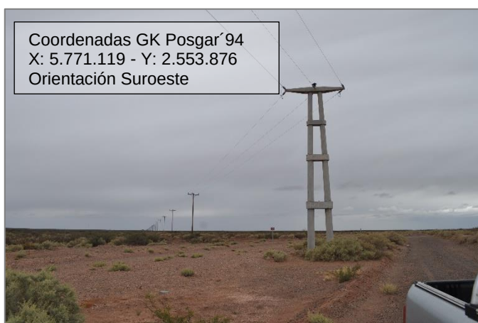
Fotografía N° 10: Línea en Media Tensión (LMT) 13,2 kV en el AID del proyecto
