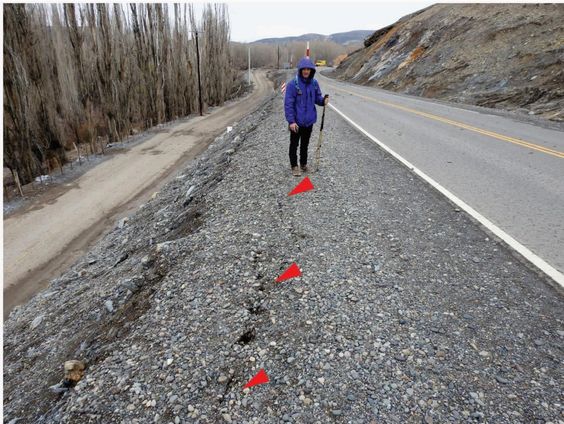
Figura 8. Fracturas de tensión sobre el borde de la banquina, desarrolladas frente al sector de deslizamiento del bloque C4. Los gaviones ubicados en la parte lateral inferior, muestran leves signos de deformación.
