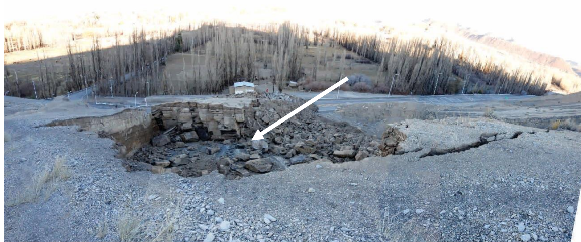
Figura 9. Vista general de la superficie de deslizamiento (indicada por la flecha). Nótese la presencia de humedad sobre la misma.
