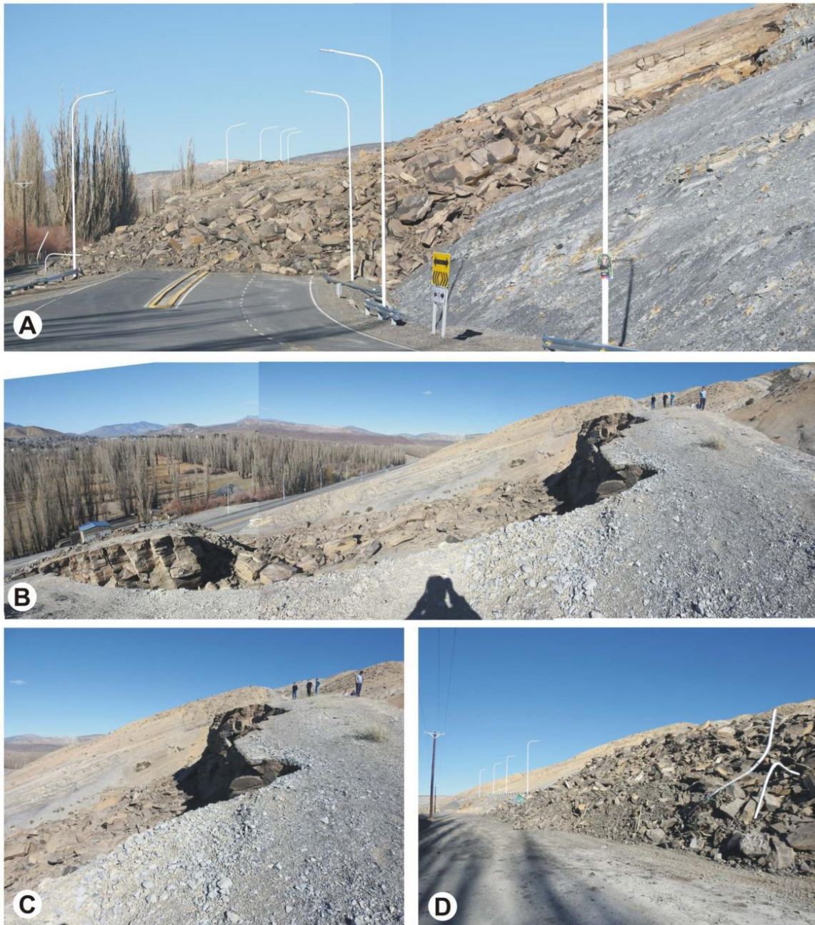
Figura 5. A) Acúmulo del cuerpo frontal o pie del deslizamiento. B) Escarpa principal (a la derecha) y parte del cuerpo principal (a la izquierda). Nótese el espacio resultante entre ambos elementos. C) Detalle de la escarpa principal y corona del deslizamiento. D) Extremo frontal del deslizamiento. Los elementos de la infraestructura vial, fueron arrastrados por el mismo.
