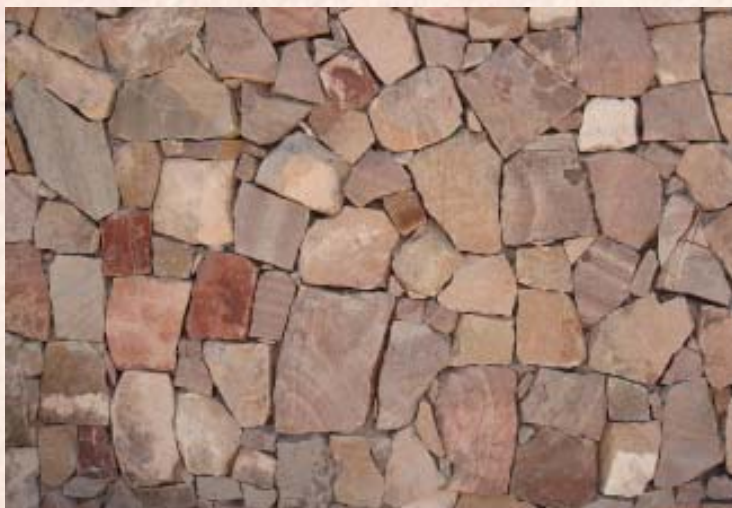
Detalle de paredón en vivienda
