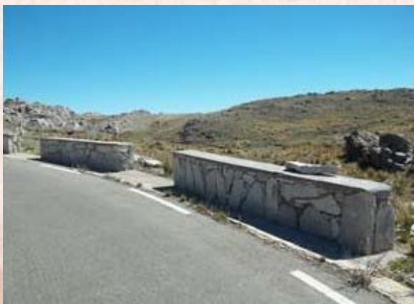
Barandilla protectora en ruta
