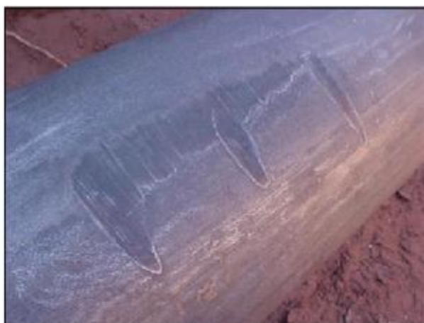
Figura 4. Defecto de pérdida de metal producido por medio mecánico
