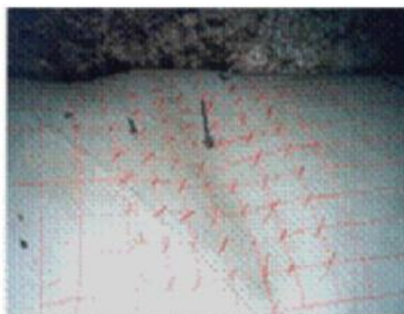
Figura 3 - Abolladura coincidente con soldadura helicoidal
