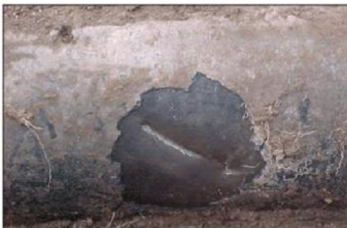
Figura 2 - Rayadura provocada por una maquina pesada
